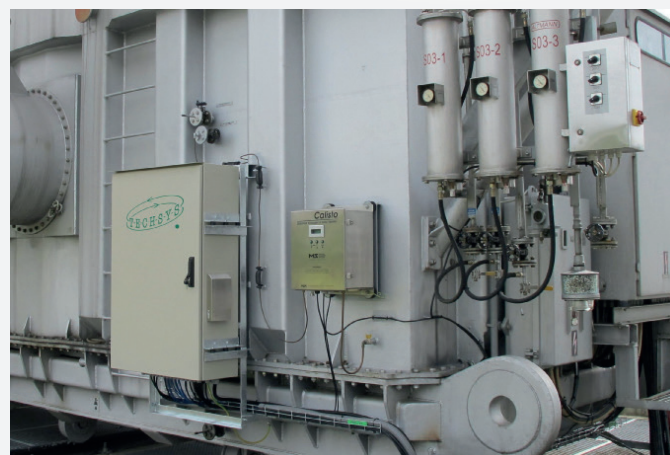
Rozvaděč MST TECHSYS na nádobě transformátoru 350 MVA 400/110 kV
