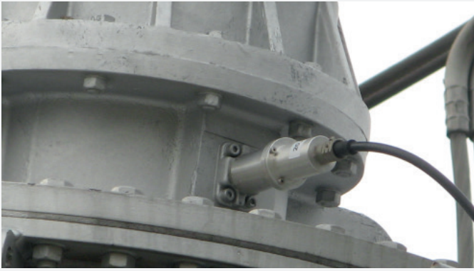
Detail připojení měření použitého pro diagnostiku průchodek na straně 400 kV
